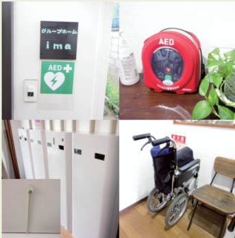
玄関にはAEDが設置され近隣の方も利用可能。車いすやスプリンクラーも配備されています。
